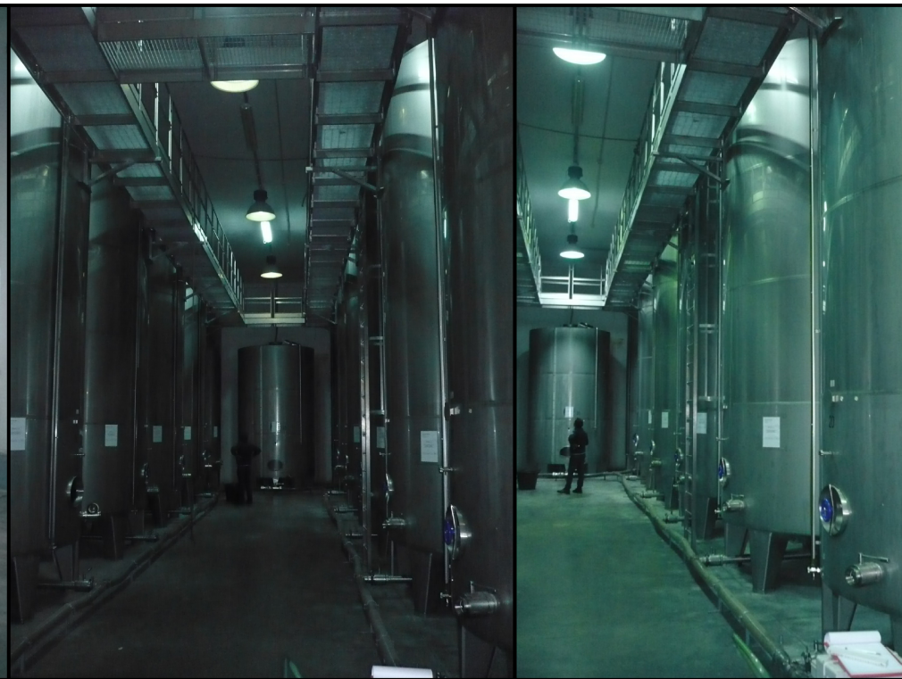
FOTO n° 16 deposito interrato olio in serbatoio di acciaio
